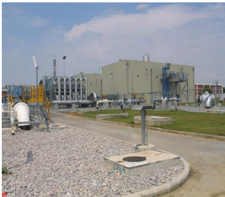
Εικόνα 1: Σταθμός Συμπίεσης στην περιοχή Νέας Μεσήμβριας Θεσσαλονίκης
